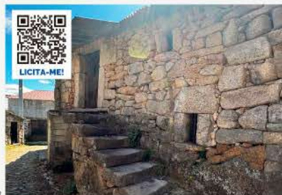
MORADIA EM RUÍNA LORDOSA, VISEU
